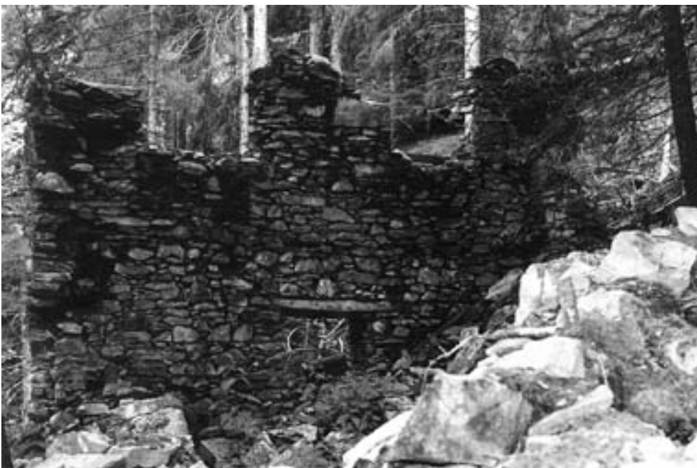
Abb. 2 Letzte noch stehende Fassade eines der Knap- penhäuser - nun auch un- mittelbar vom Einsturz be- droht. (Foto St. Wanner, 1999)
