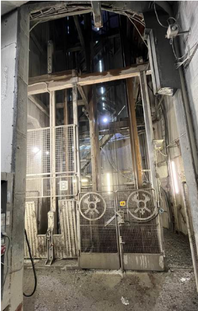
Schachtlift auf Sohle 800m mit dem alten Firmensymbol
