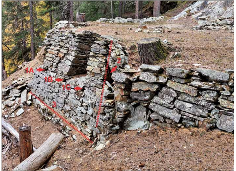
Seilbahnplattform-Frontmauer mit markierten Auffälligkeiten.
