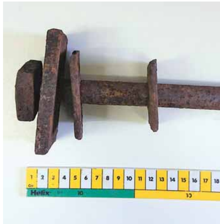
Schraube mit Unterlagscheibe, gefunden auf dem Zugangsweg.
