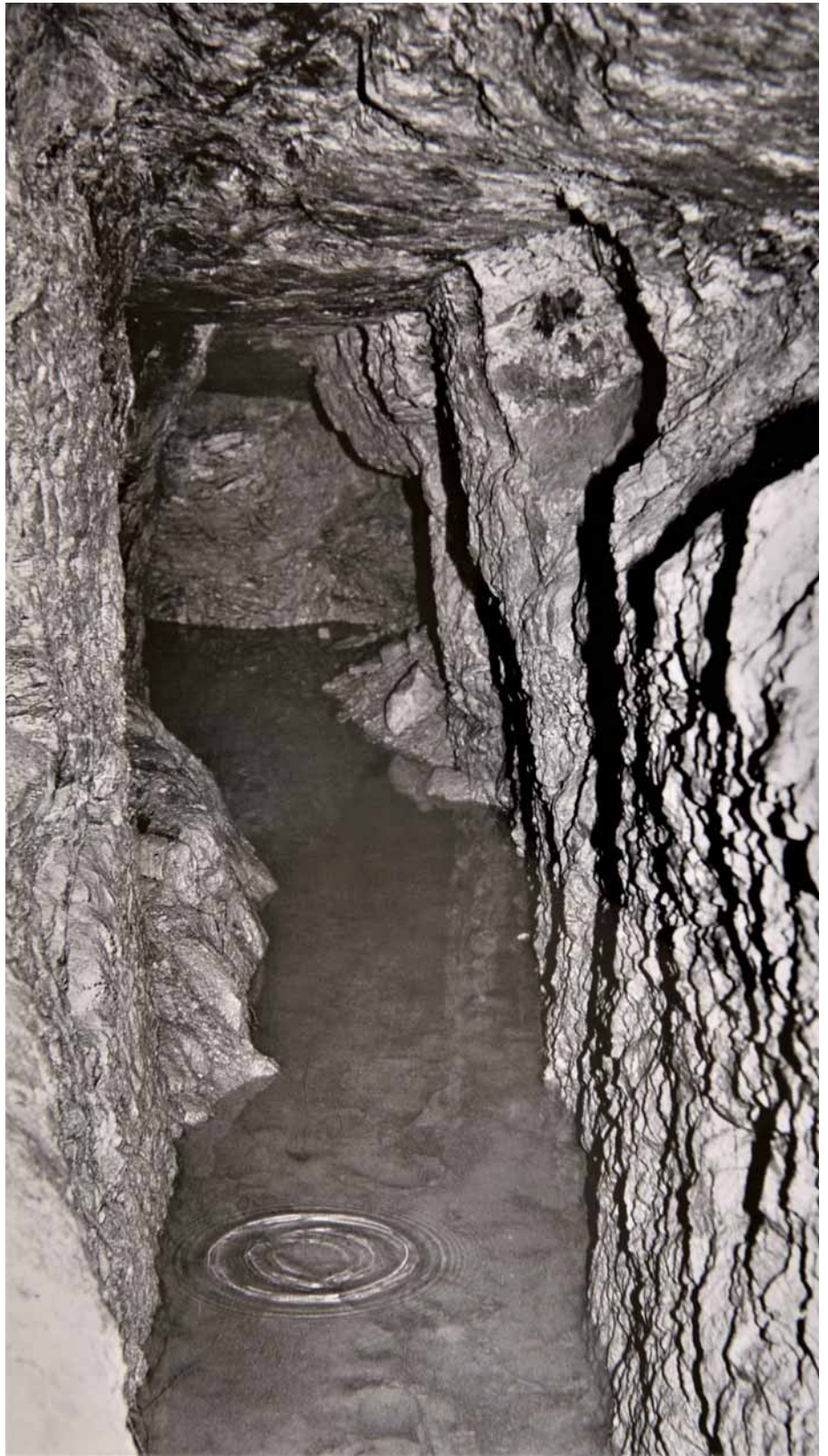
Es tropft im Stollen unter der Kantonsstrasse.
