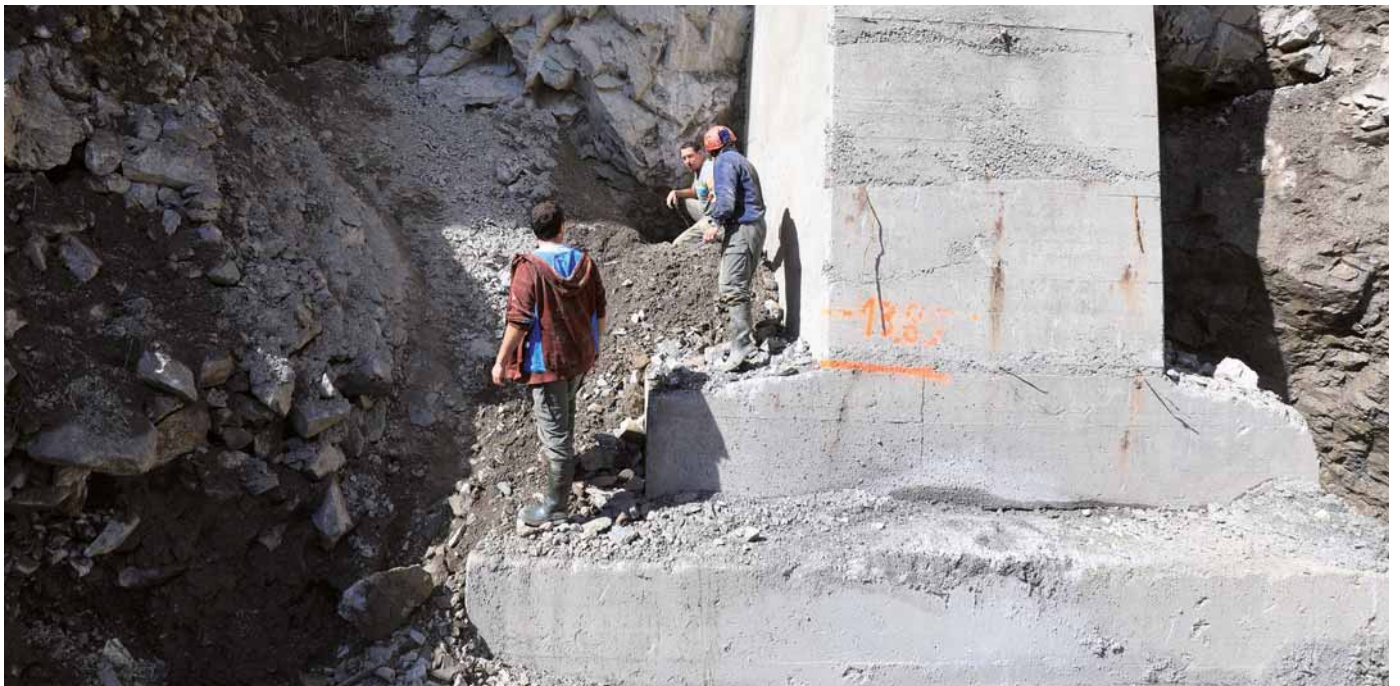
Der neu entdeckte Abbau am Fuss des Pfeilers.
