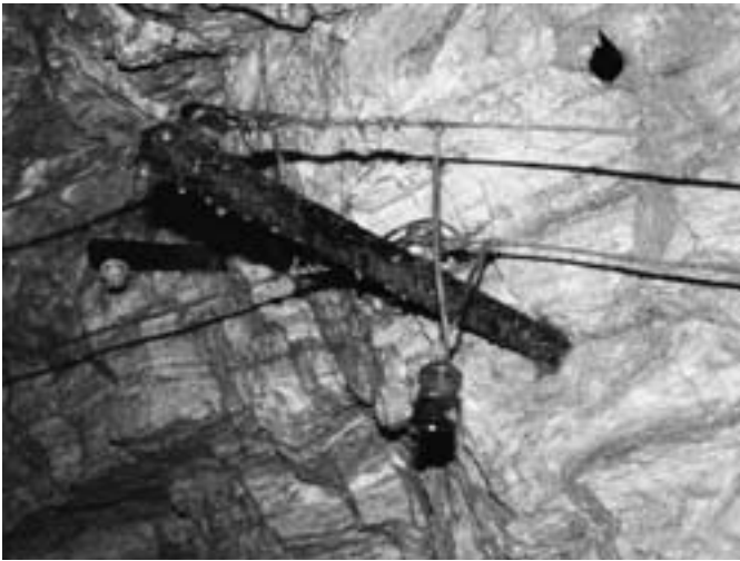
Die Beleuchtung im Stollen.
