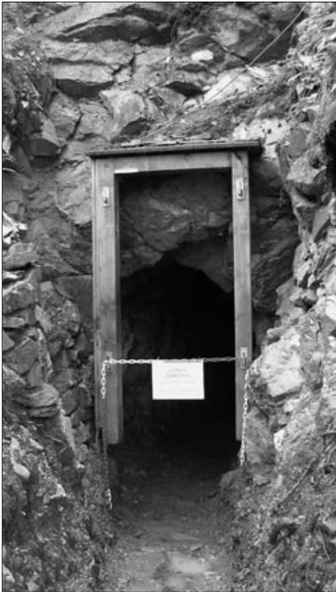
Abb. 1: Zustand der zerrütteten Zone des Mundlochs.
