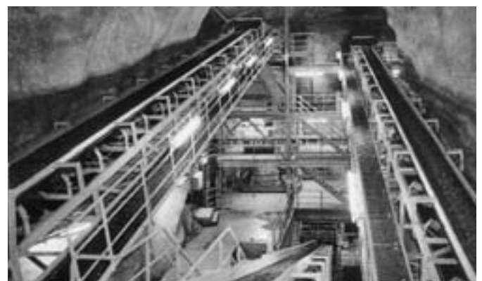
Abb. 13: Brecheranlage in einer Kaverne in 400 Metern Tiefe.
