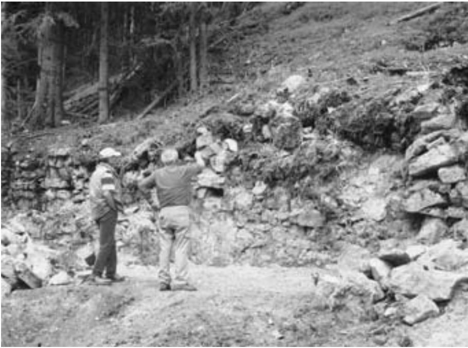
Abb. 2.3 Zerrüttete Gebäudewand bergseits nach dem Ausgraben und vor dem Neuaufbau des Mauerwerks.
