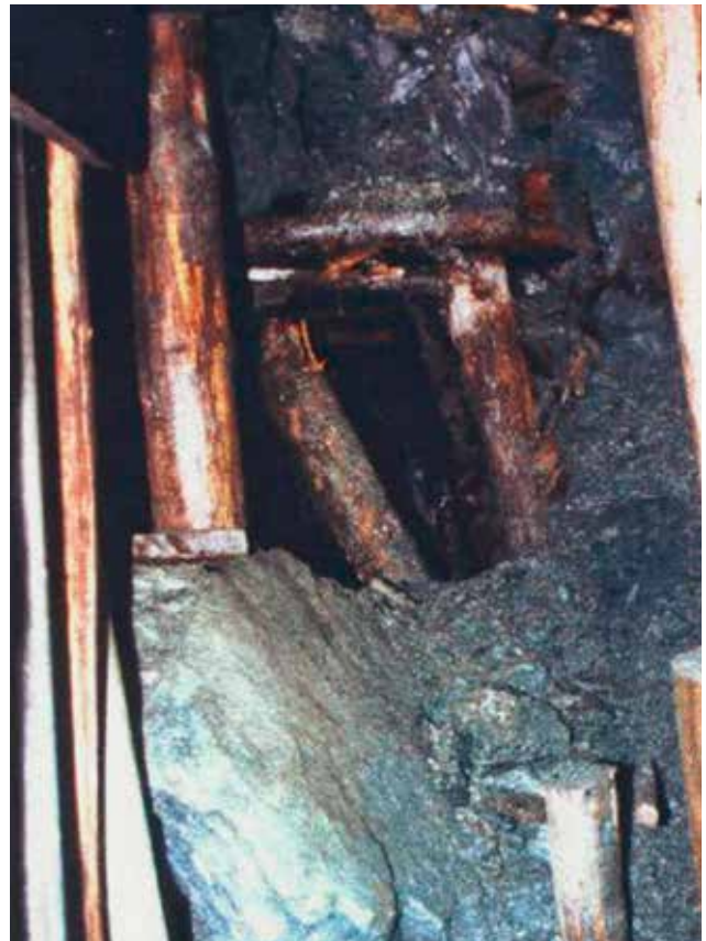
St. Lucia: Verbruch und alte Zimmerung.
