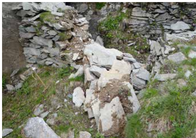
Die Bruchsteinmauer liegt am Boden. (Fotos Rebm)
