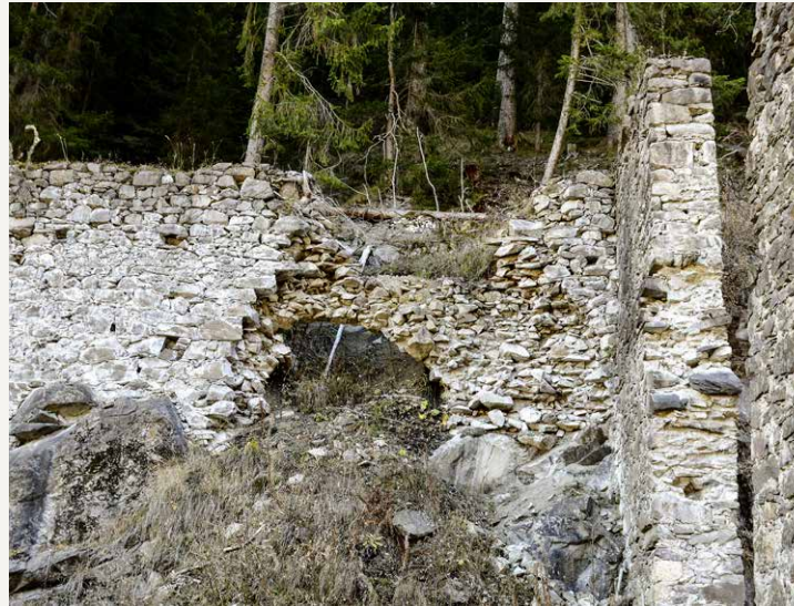
Die bergseitige Stützmauer muss dringend gesichert werden, um den weiteren Zerfall aufzuhalten.
