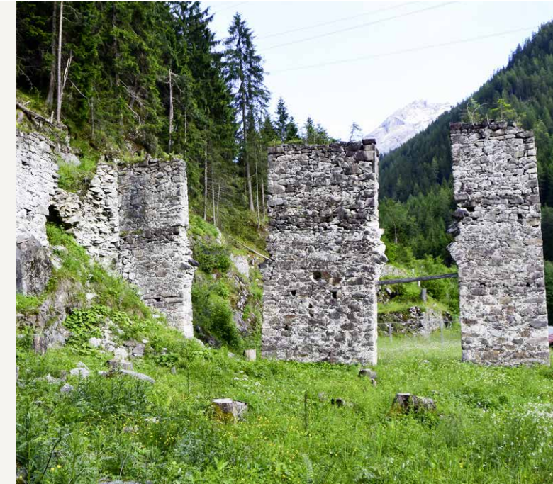
Sicherungsmaßnahmen sind dringend nötig: Die Stützmauer links zerfällt, der mittlere markante Pfeiler droht, von starken Winden umgestossen zu werden.
